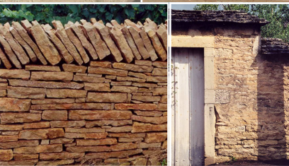
Sans enduit ou sous un mauvais enduit, la pierre peut souffrir et se désagréger
